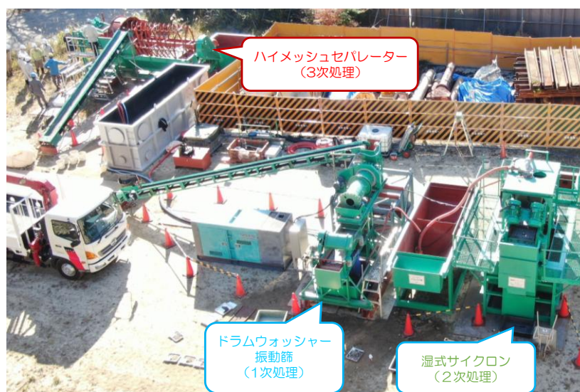
図 7-1 矢作ダムで実施された分級実験のプラント全景（2023 年度）
