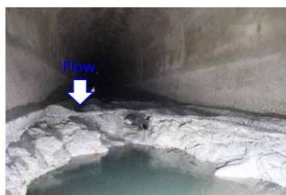
バイパストンネル内の摩耗状況
